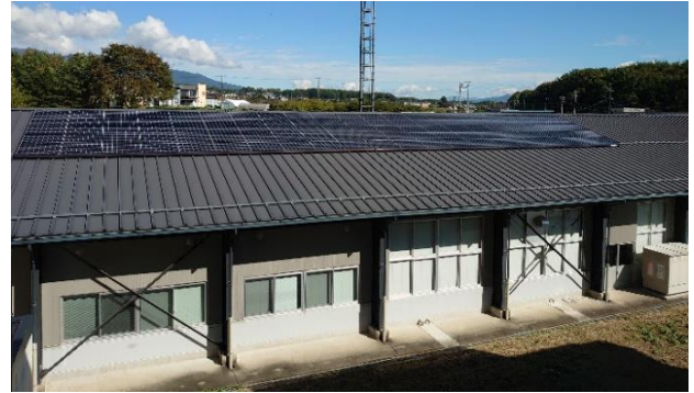
図 1 太陽光パネル設置状況
