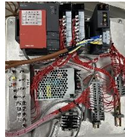
図4 自作した制御盤
